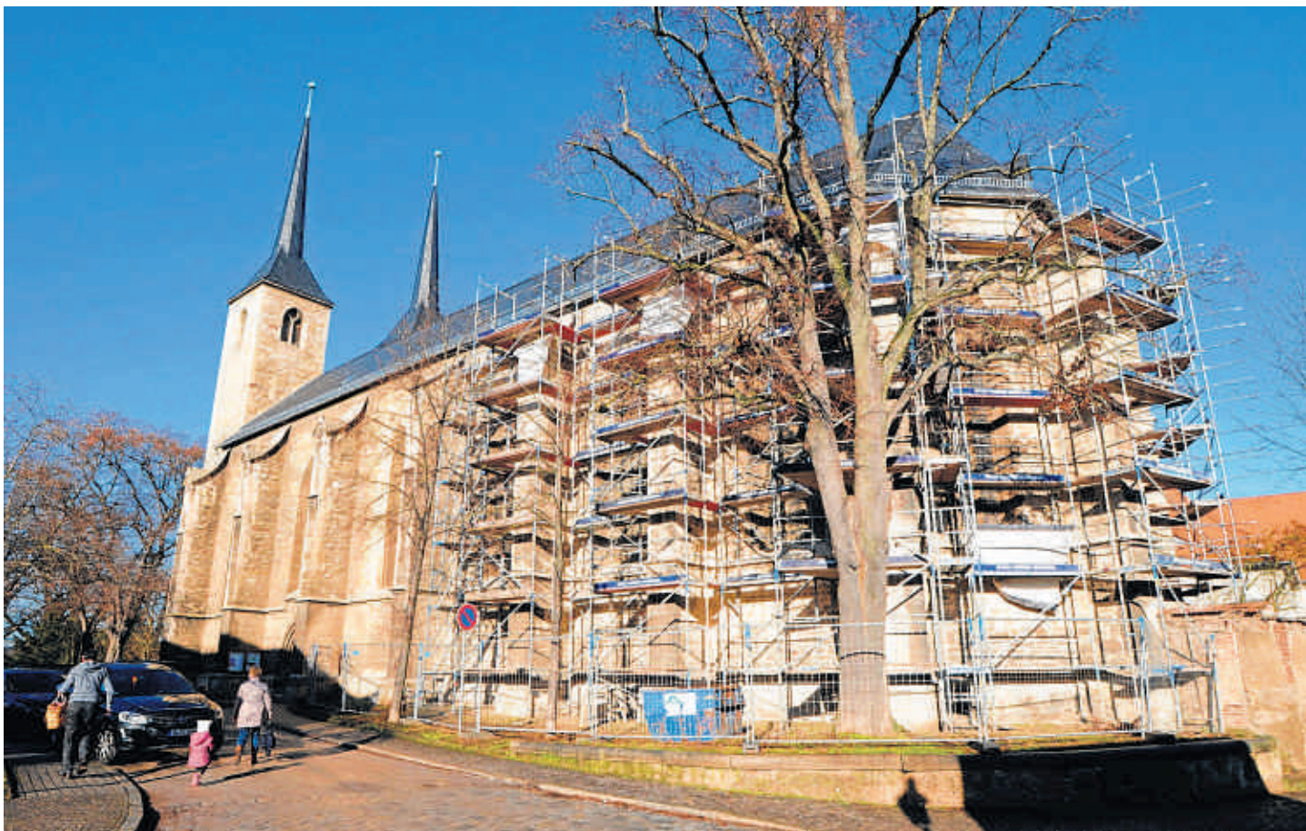
Eingerüstet: Nach der Sanierung des äußeren Mauerwerks soll ein Gutachten zum Zustand der drei Glasfenster im Chor der Naumburger Moritzkirche in Auftrag gegeben werden. Für die Arbeiten am Mauerwerk unterstützt der Förderverein die Kirchengemeinde mit 6 000 Euro.
